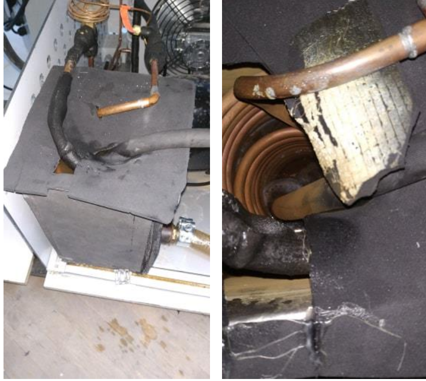
Şekil 3.15. Soğutucu sistemin rezervuarı.
