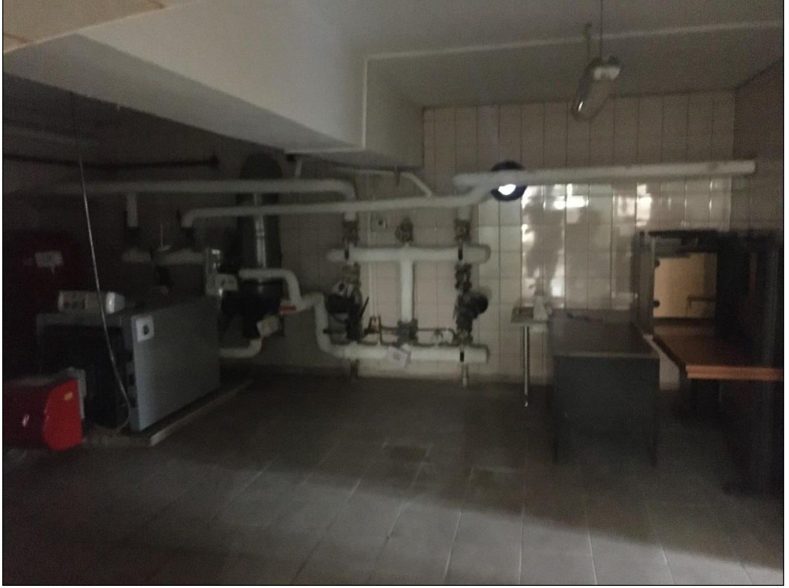
Şekil 5.145 Bodrum kat ısı merkezi görünüşü (Yağcı, 2020).
