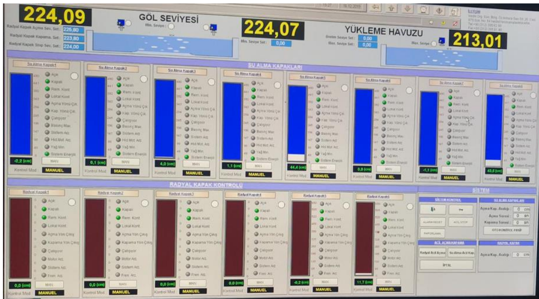
Figure 6.3. Yalnızca RRHPP forebay SCADA screen
