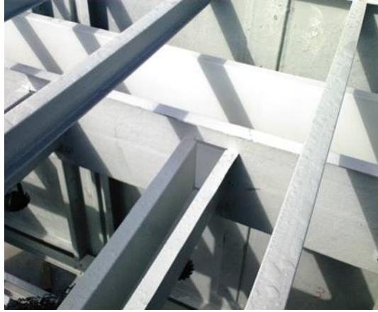
Şekil 6.15. Soğutma kulesi dağıtım sistemi.
