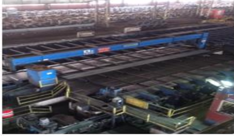
Şekil 2.7. Kontinü haddehane tesisi paketleme ünitesi
