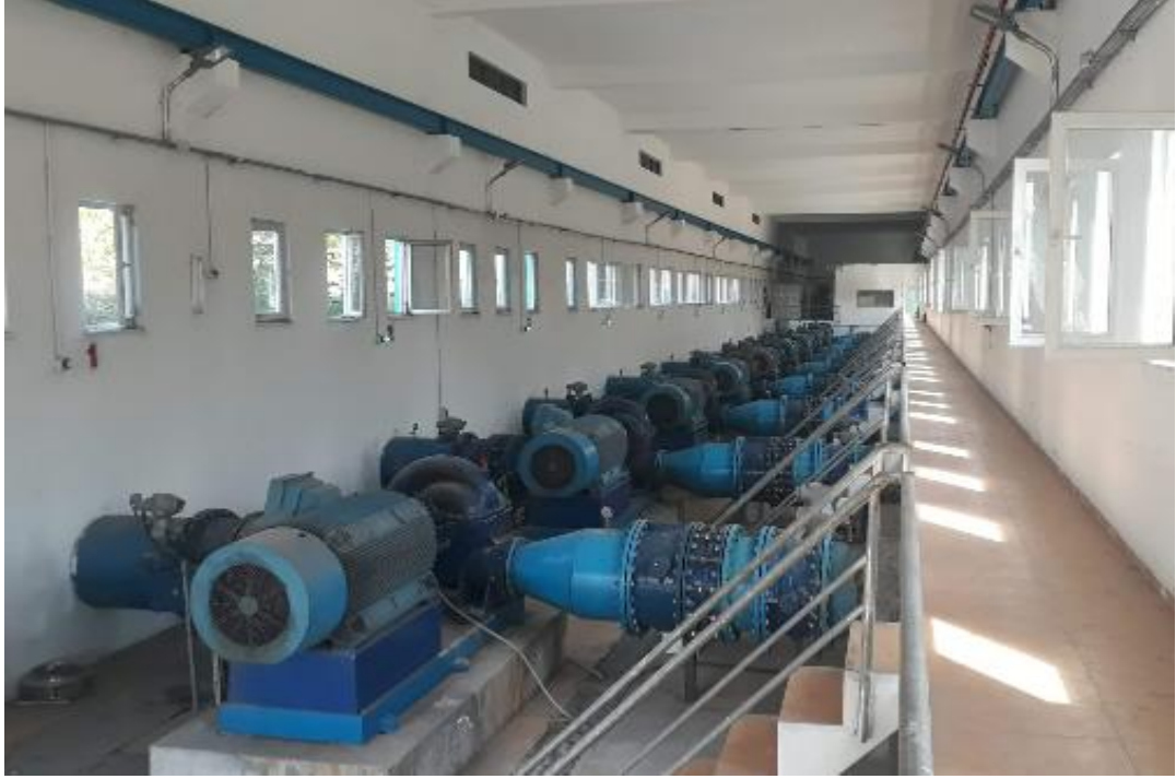
Şekil 4.2. Terfi istasyonu yakından görünüm 1.
