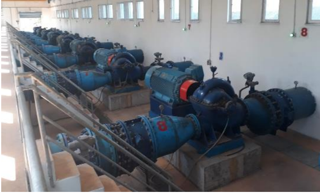
Şekil 4.3. Terfi istasyonu yakından görünüm 2.
