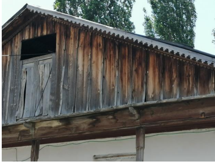
Şekil 5.11. Çatı saçaklarında yer alan furuşlar
