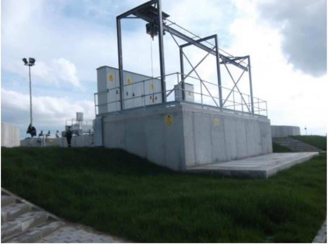
Şekil 4. 16. Geri devir ve fazla çamur pompa istasyonu.
