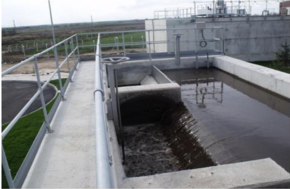
Şekil 4. 11. Havalandırma havuzları dağıtım odası.
