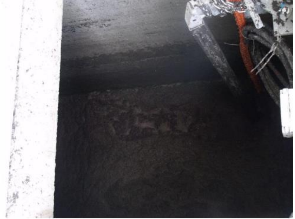
Şekil 4. 30. Süzüntü pompa istasyonu.
