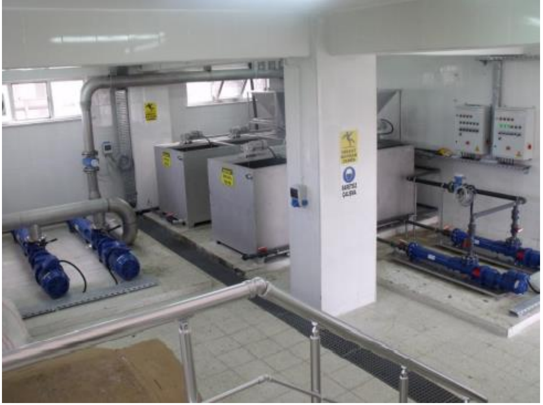
Şekil 4. 21. Çamur terfi pompaları ve polimer hazırlama ünitesi.
