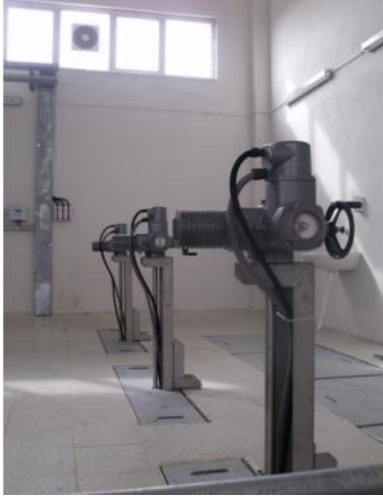
Şekil 4. 8. Giriş terfi pompaları.
