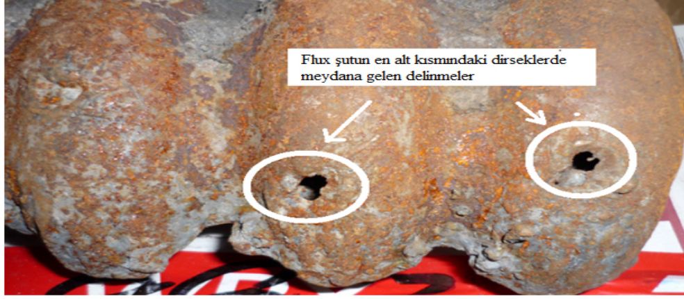
Şekil 4.14. Kardemir A.Ş. BOF flux şutun planlı bakım duruşlarında yapılan kontrollerde gözlenen aşınma görüntüsü.
