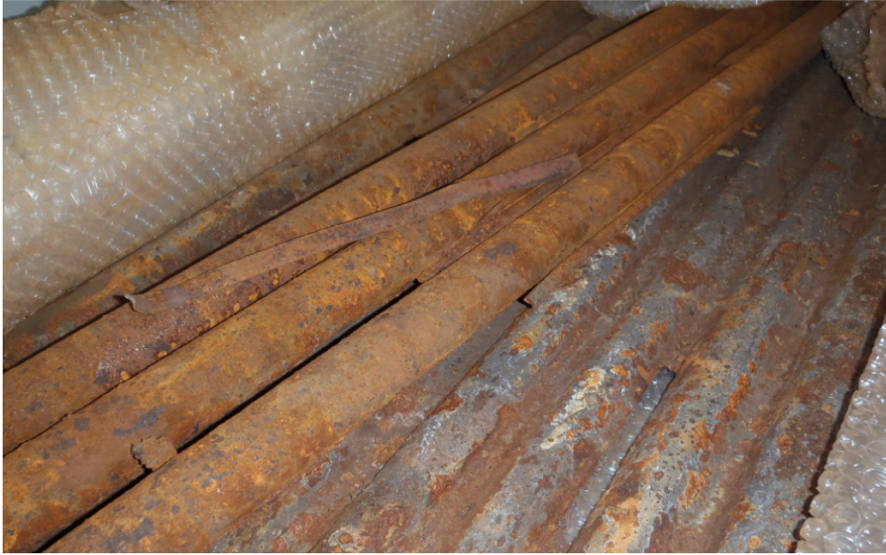
Şekil 4.13. Kardemir A.Ş BOF flux şut değişimi sonrası oluşan aşınmanın yakın fotoğraf görüntüsü.
