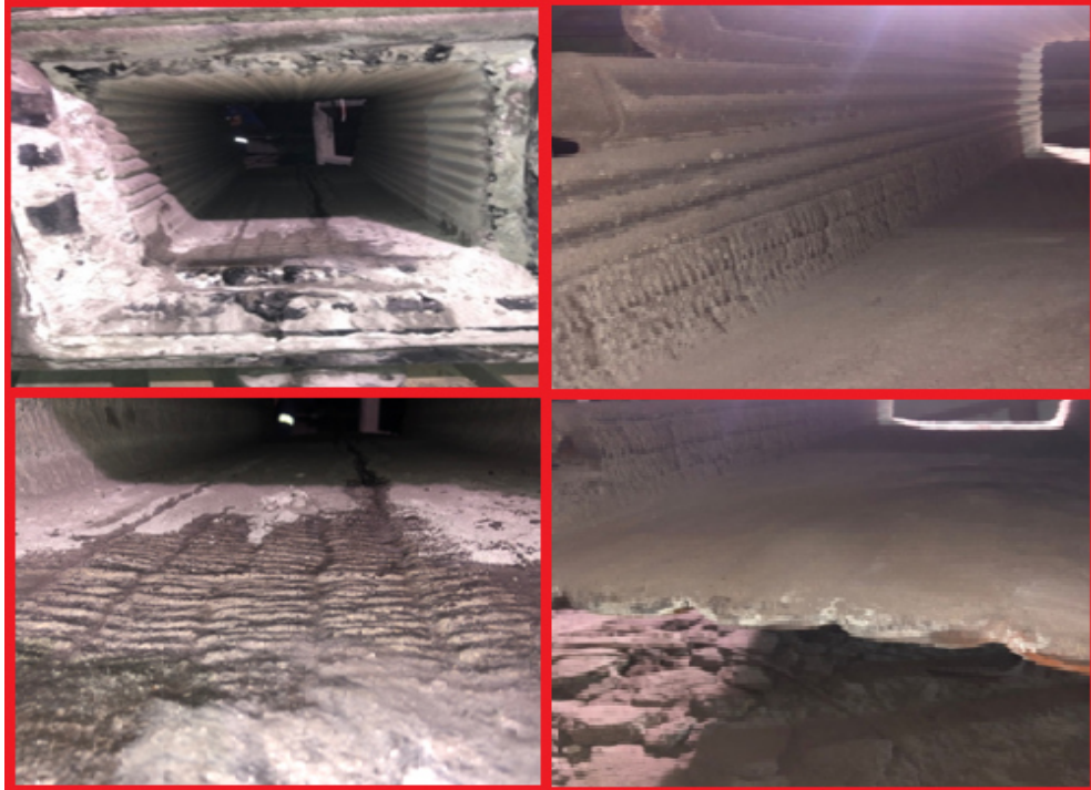
Şekil 4.21. Flux şutun taban yüzeyinin tamamı ile yan duvarların ilk 3 sıra boru yüzeyleri Thermanit 14 K Si ilave tel ile kaynak dolgusu yapılarak BOF sistemine montaj yapılmış hali ile 24 ay çalışma süresi sonucunda gözle görünür bir aşınma veya delinme olmadığının saha görüntüsü.
