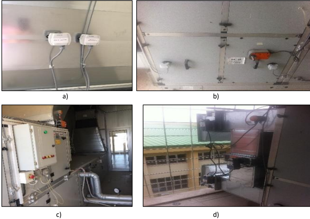
Şekil 4.3. a ) CO 2 sensörü, b ) Plakalı ısı geri kazanım cihazı, c) Klima santrali ünitesi, d) Karışım ünitesi
