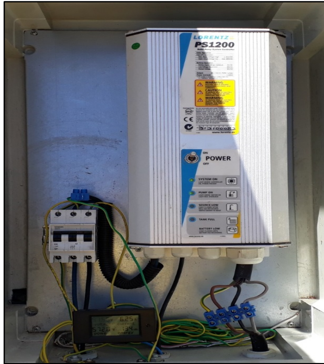
Şekil 4.5. Pompa sürücüsü ve kontrolcüsü ile wattmetre.
