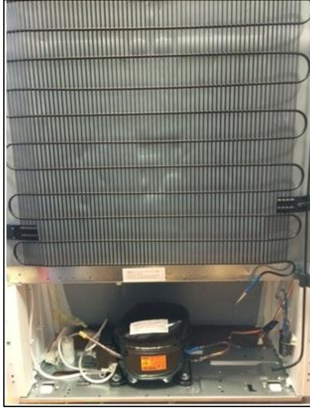
Şekil 3.3. Soğutma sistemine ait doğal taşınımlı hava soğutmalı yoğuşturucu.
