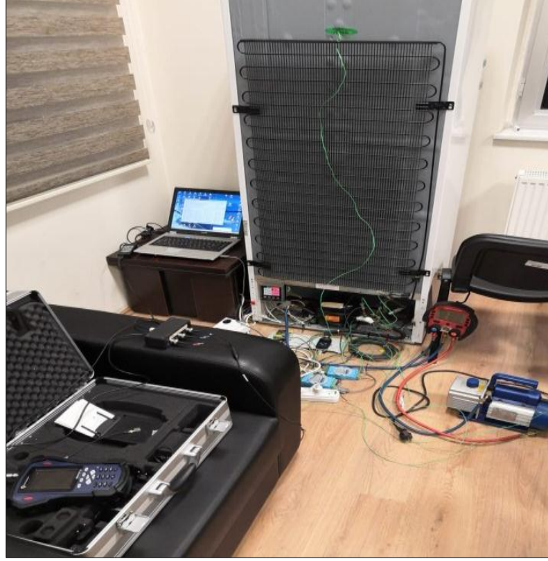
Şekil 4.2. Soğutma sistemi ve soğutma sistemi üzerindeki ölçüm cihazlarının yerleşimleri
