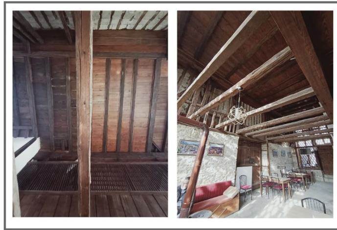
Şekil 4.18 Keçeci Mehmet Ulucan Şehir Evi hayat kısmında yer alan ahşap taşıyıcılar (Ünal,2021).
