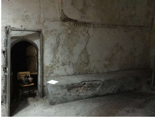
a) Ilıklık kısmında görülen bozulmalar
