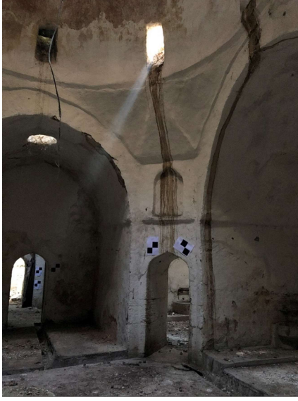
a) Sıcaklık kısmı kısmında yer alan bozulmalar
