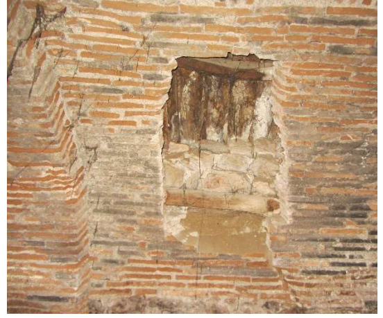
b) Tonoz üzerinde tahribata uğrayan kısım
