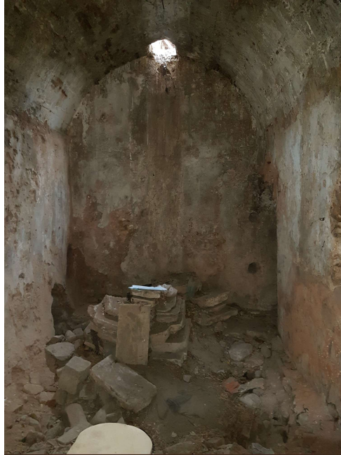
b) Ilıklık mekânında yer alan tahribatlar
