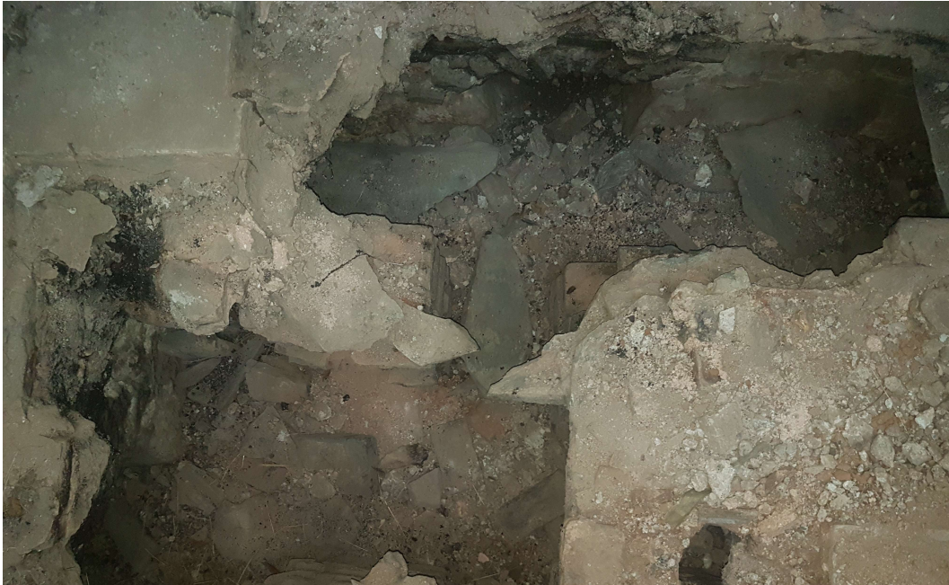
Şekil 3.14. Hatip Hamamı döşemesinde meydana gelen tahribat sonucu oluşan açıklık.
