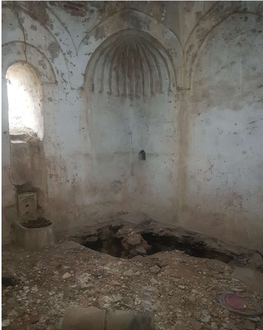
a) Sıcaklık kısmının döşemesindeki tahribat
