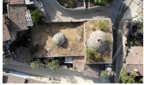
b) Paşa Hamamı üst örtüsündeki bozulmalar
