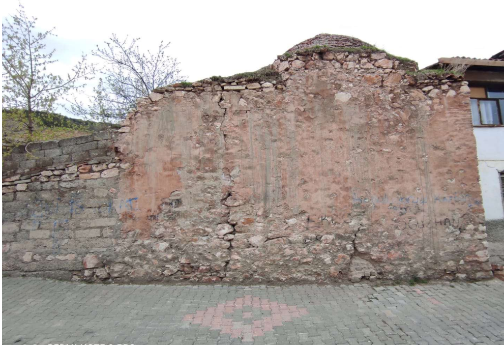
Şekil 3.124. Dış cephedeki bozulmalar
