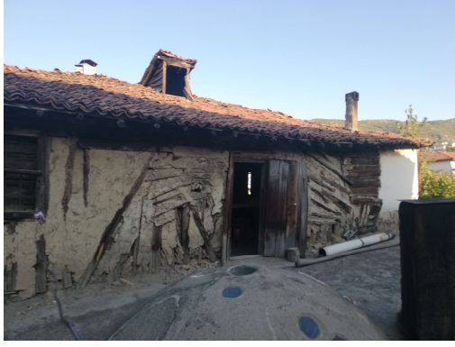
a) Kurutmaliğın dış duvarlarındaki bozulmalar
