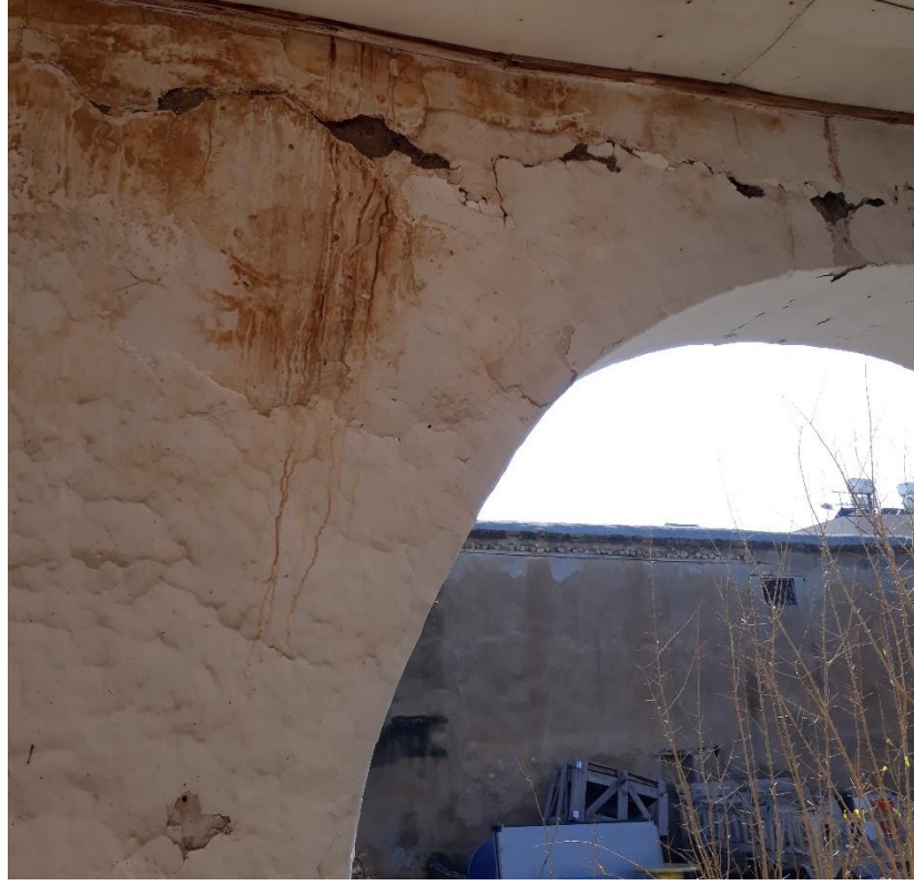
Şekil 2.1. Yağmur suları etkisiyle sıva kabarması sonucu oluşan hasara örnek.
