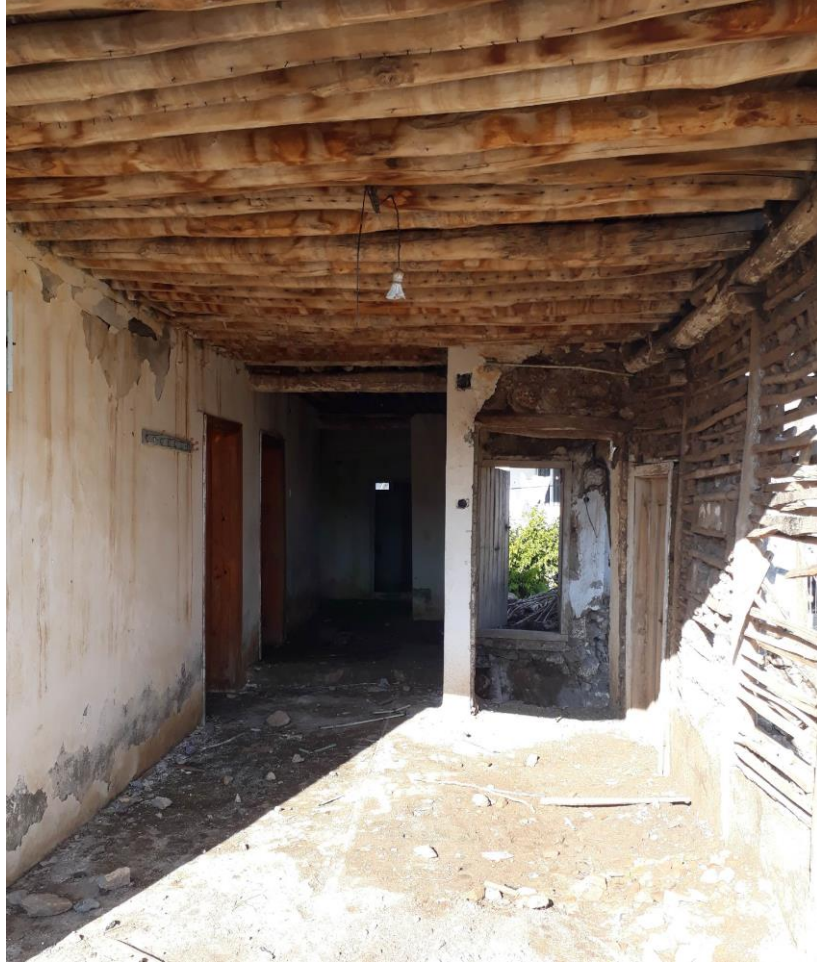
Şekil 2.5. Bakımsızlık ve terk sonucu oluşan hasara örnek.
