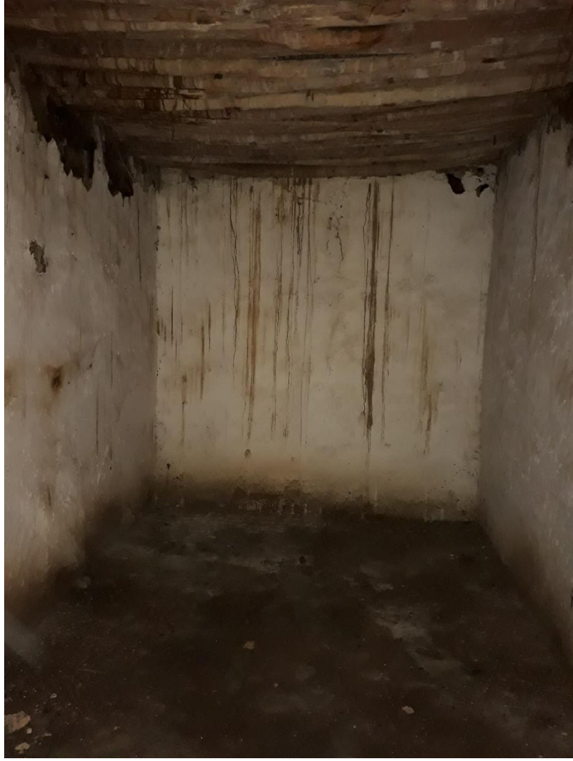
Şekil 2.3. Çatının su geçiriminin önlenememesi sonucu kullanılamaz hale gelen oda.
