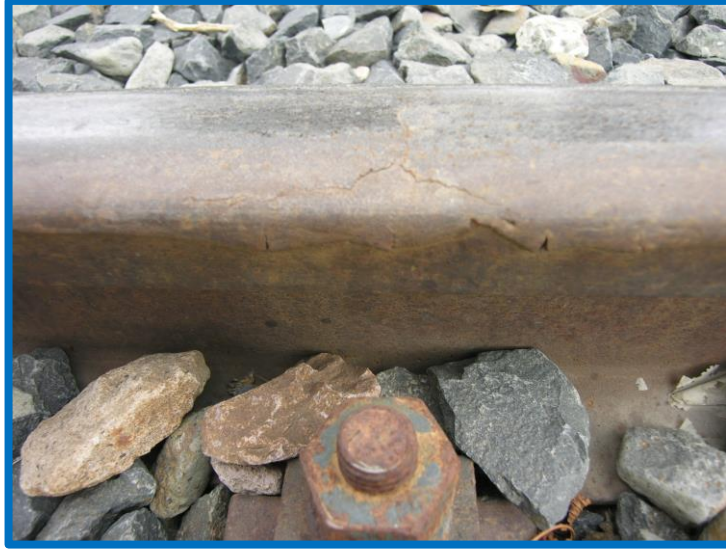
Şekil 2.23. Ray mantarı çatlakları [21].
