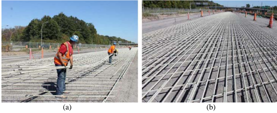
Şekil 2. GFRP donatılı beton yol uygulaması: GFRP çubukların yerleştirilme aşaması (a), yerleştirme sonrası (b) [6]
