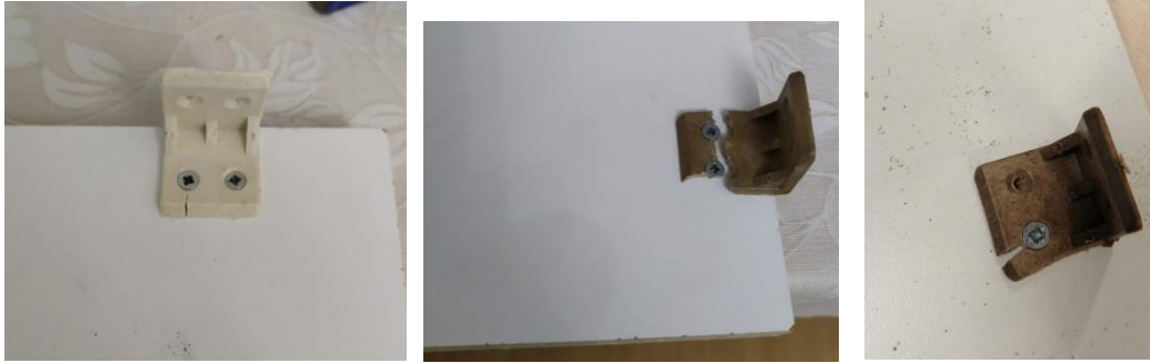
Şekil 1.C. L bağlantı elemanlarının montajı sırasında meydana gelen kopmalar ve çatlamalardan bir görünüş.
