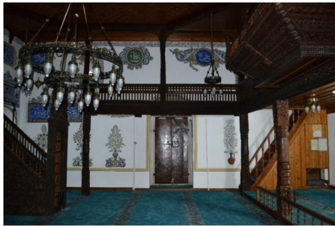
Foto. 268: Turnalı Mahalle Cami-Batı Duvarı
