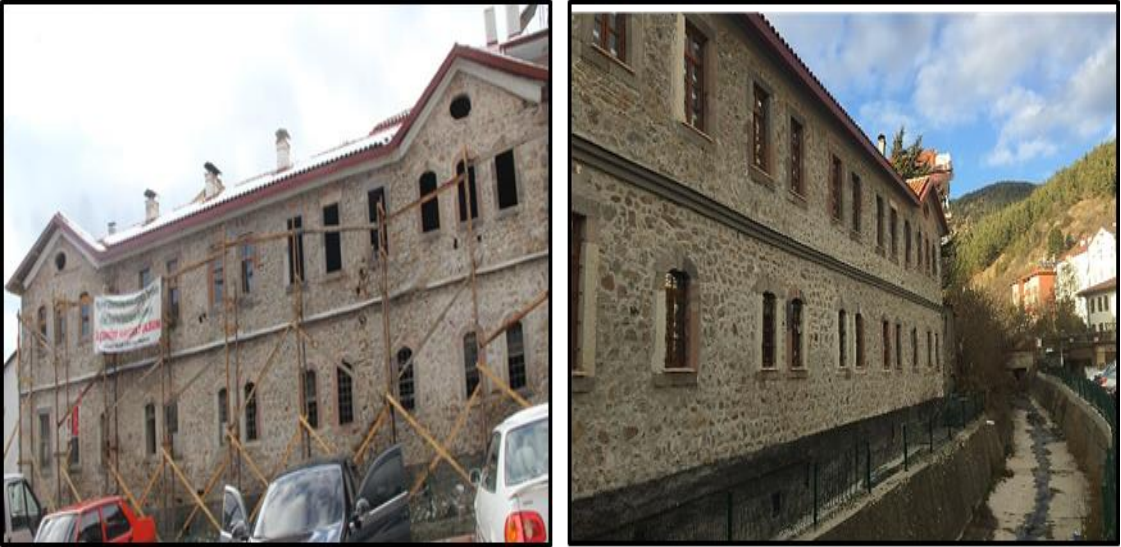
Fotoğraf 60. Kiliseli Tüccar Hanının iç kısmının Restorasyondan Önceki ve Restorasyon Sırasındaki Hali
