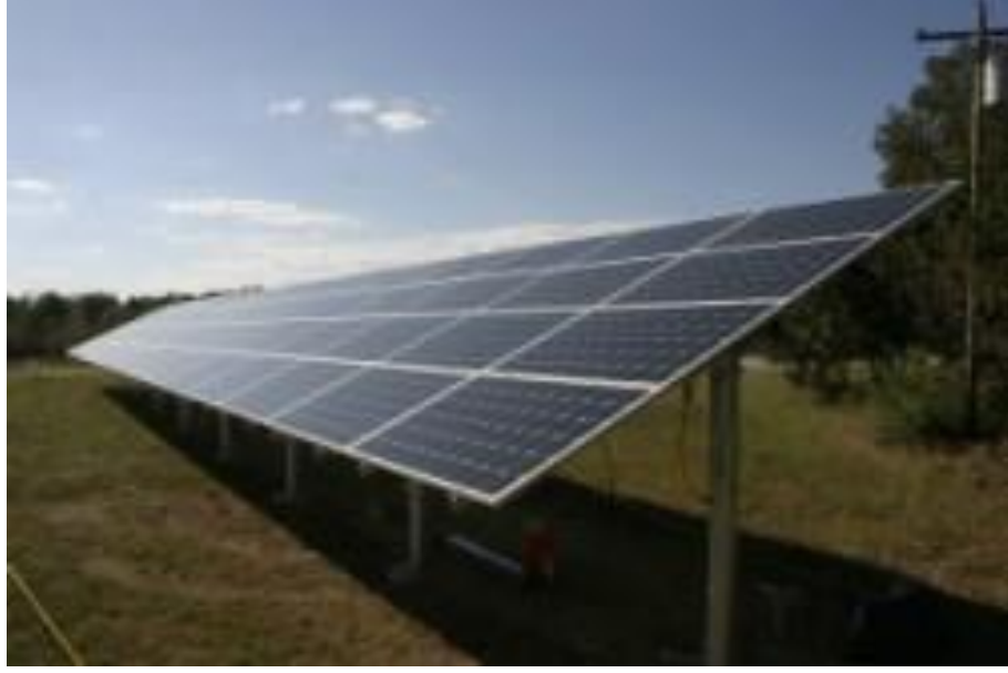
Fotoğraf 23. The Farm Ekoköyü'nde Güneş Fotovoltaikleri (URL-31)
