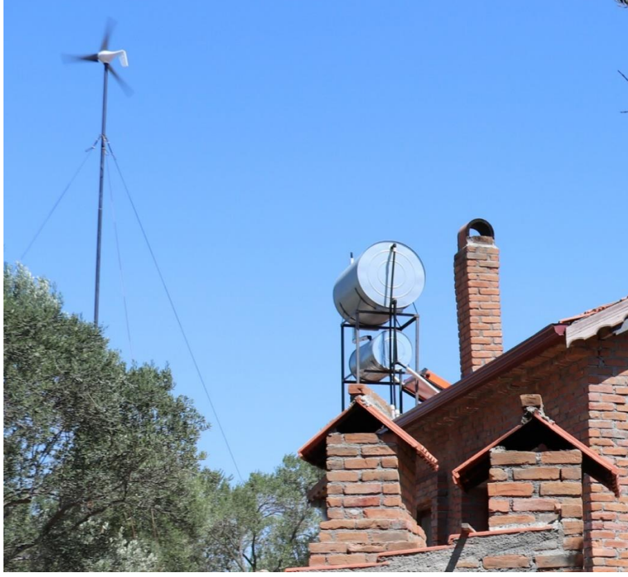
Fotoğraf 123. Ev Tipi Rüzgâr Türbini ve Güneş Enerji Sistemi
