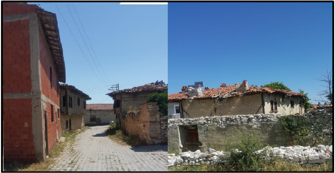
Fotoğraf 84: İç Anadolu Bölgesinde yer alan Porsuk Çayı Havzası'nda kerpiç evler zamana karşı duramamaktadır (Kütahya Şahmelek köyü).
