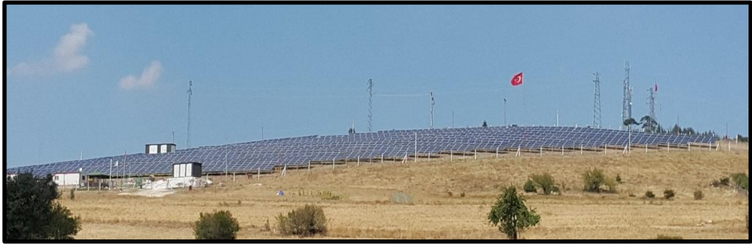
Fotoğraf 116: Mihalıççık Medrese Mahallesi'nde Eskişehir Büyükşehir Belediyesi tarafından yapılan güneş enerji santrali.
