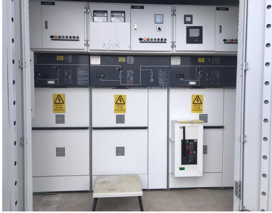
Şekil 5.5. Orta gerilim (OG) bölümü
