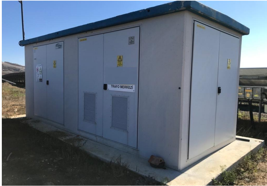
Şekil 5.2. Beton köşk trafo binası.
