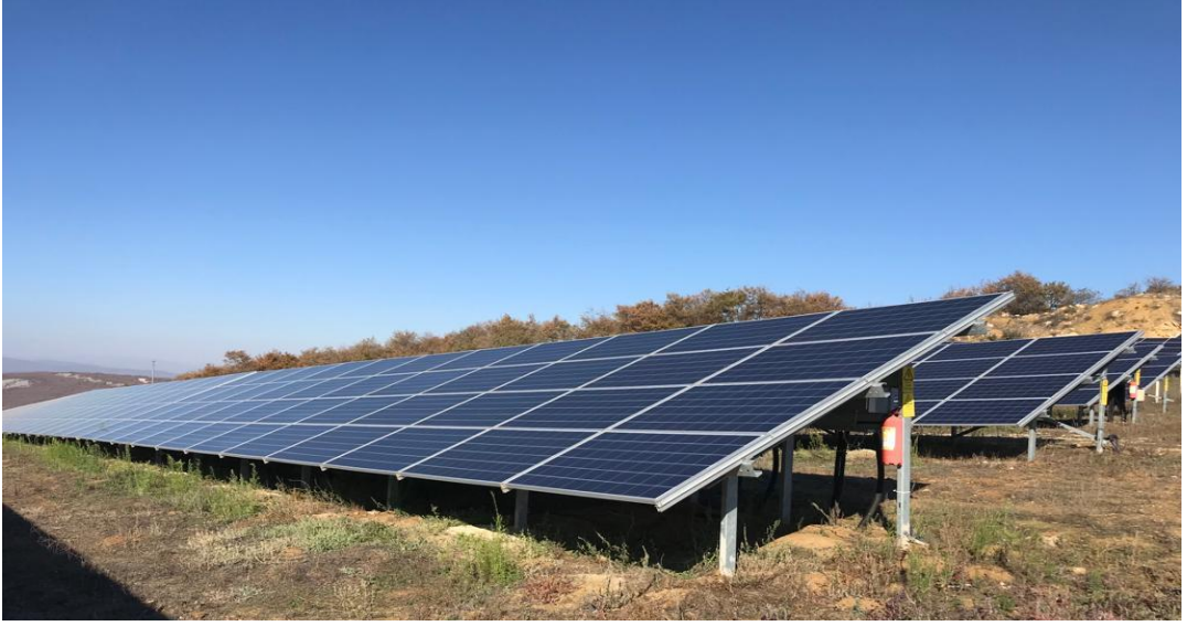
Şekil 5.7. Fotovoltaik güneş paneli seçimi.
