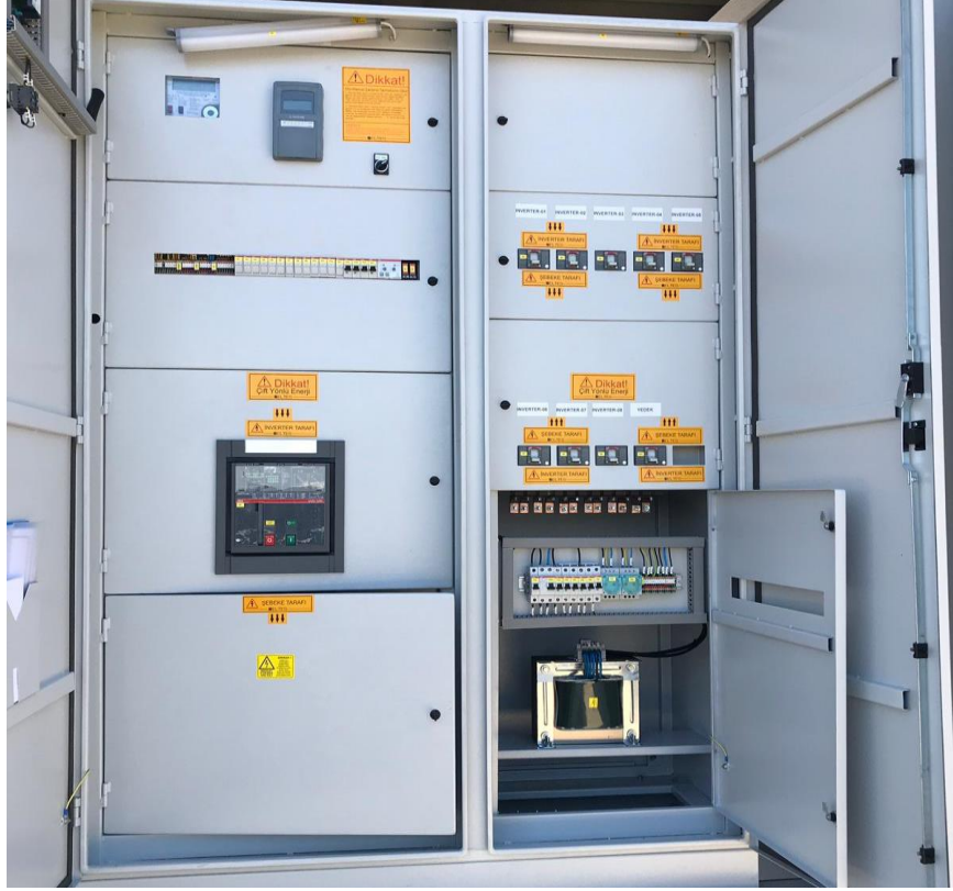
Şekil 5.3. Alçak gerilim (AG) bölümü.
