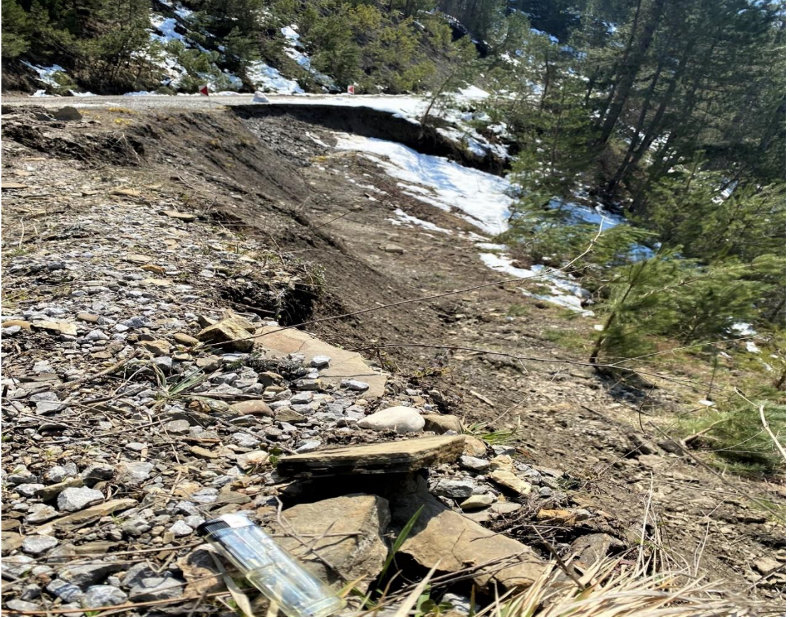
Fotoğraf 48. Ilıca mevkiinden Valla Kanyonu yolu güzergâhında batı bakılı yamaçta %60 civarı eğimli sahada, yol yapım çalışması nedeniyle yamaç dengesi bozulmuş ve bir heyelan meydana gelmiştir
