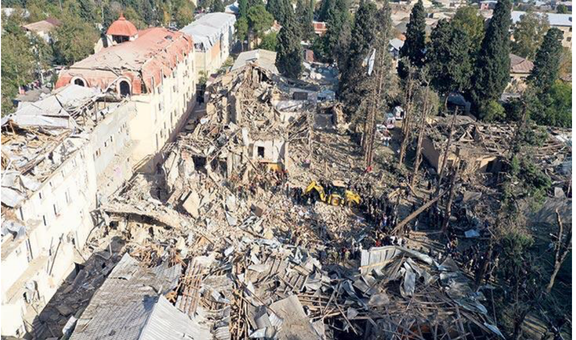
Şekil 6. Ermenilerin Gence şehrinde sivil toplumun yoğun yaşadığı yerlere fırlattığı füzeler sonucunda binaların enkazlarının bir kısmı.
