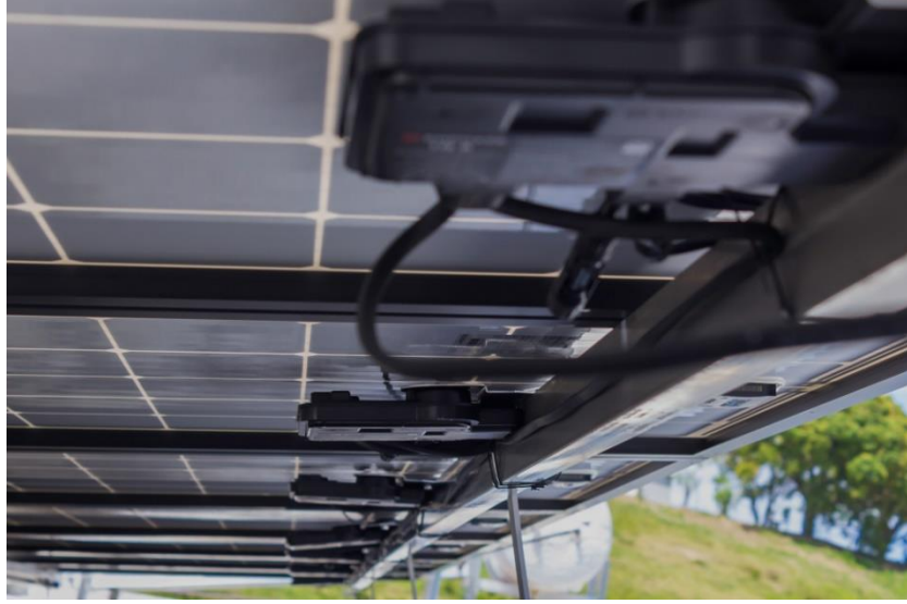
Şekil 5.39. PV panellerine bağlı mikro invertörler.
