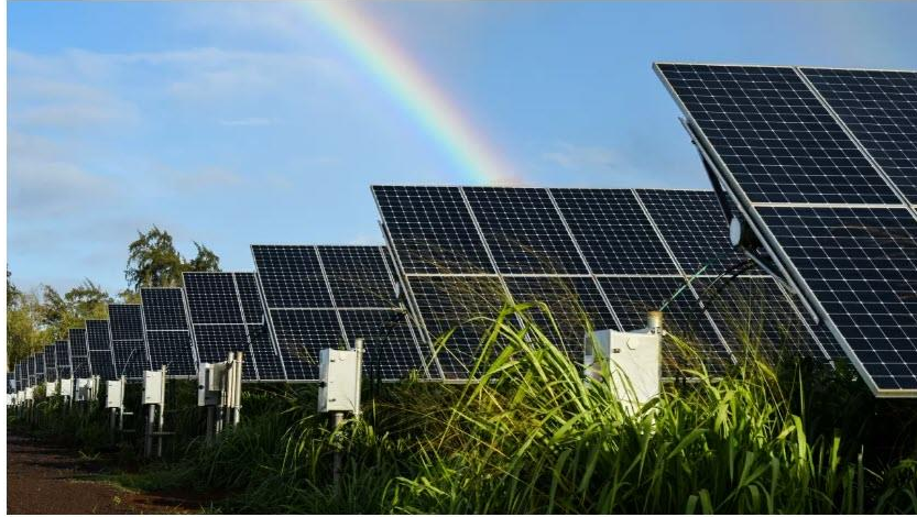
Şekil 5.37. PV panellerin dizilerine bağlı dize invertörler.
