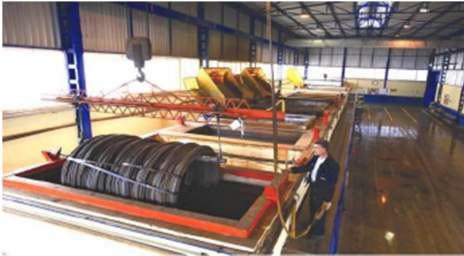
Şekil 4. 5. Yüzey işlem havuzları [42].
