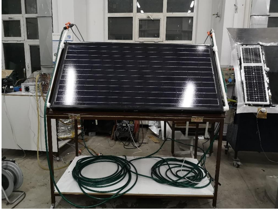
Şekil 5.3. Kurulumu yapılan FV/T sistem.
