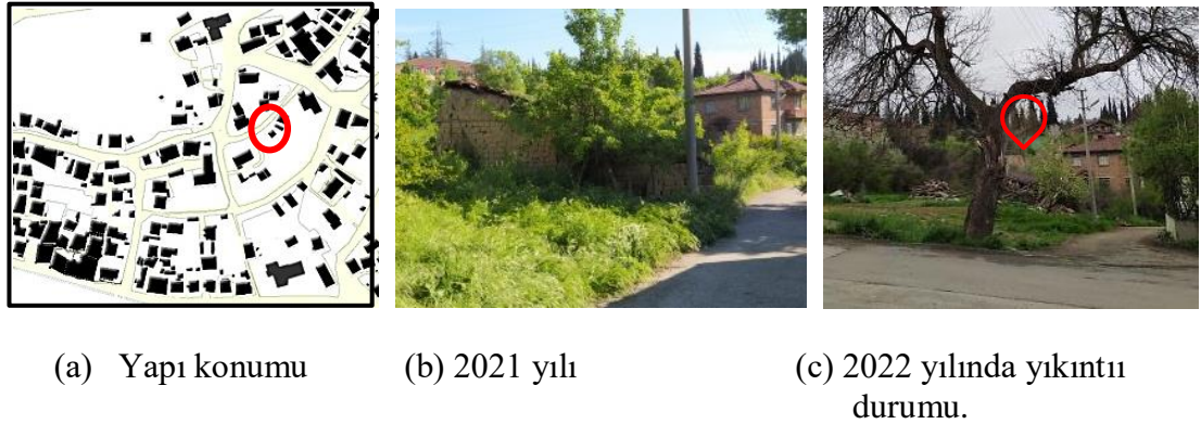
Şekil 3.73. Yıkılan bir ahır yapısı.
