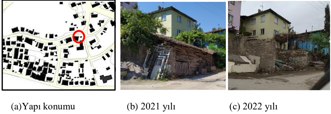
Şekil 3.72. Yıkılan bir samanlık yapısı.
