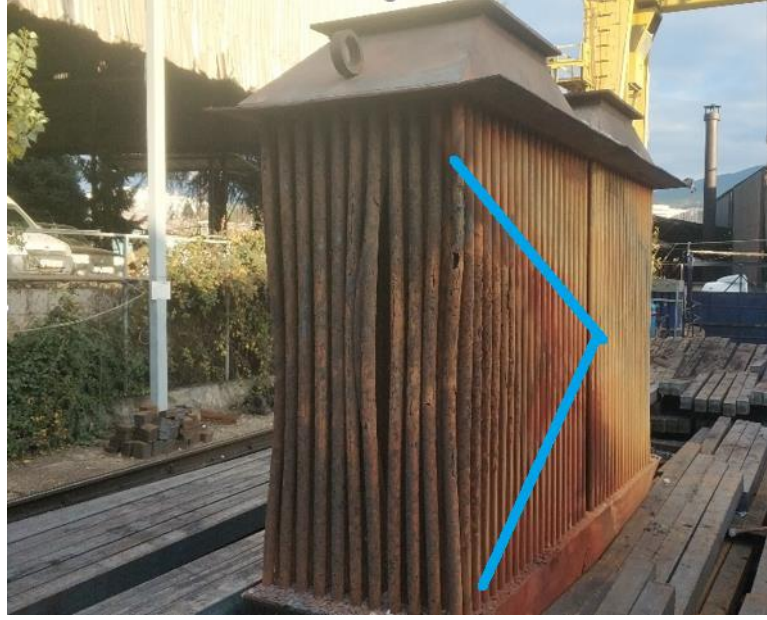
Şekil 4.6. Isı transfer boruları hasar gören reküperatör.
