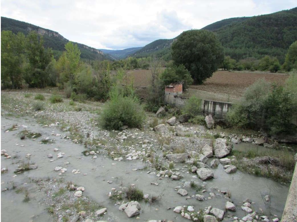
Fotoğraf 102: Akarsuyun taşıdığı kaya boyutlarının büyük olması bu mevkide akarsuyun taşıma gücünün bir zamanlar fazla olduğunun göstergesidir. Ayrıca akarsu taşıdığı materyaller ile akarsu yatağına inşa edilen yapıyı kullanılmaz hale getirmiştir. Bu fotoğrafta sahada daha önce bir taşkın afeti yaşandığını gözlemlemekteyiz.
