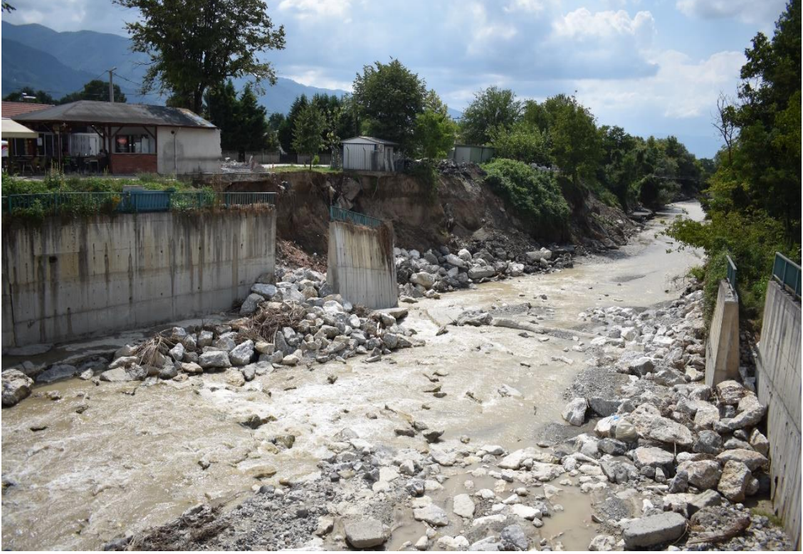
Fotoğraf 3. Uğursuyu Deresi'nin Taşkın Sonucu Verdiği Tahribat
