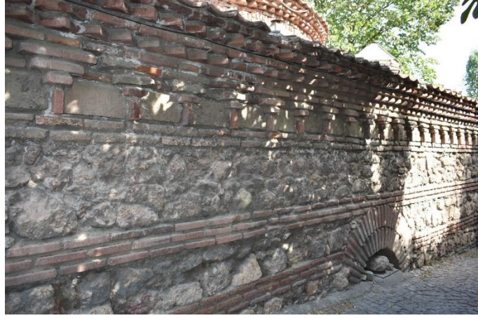
Fotoğraf 195: Bursa Eski Kaplıca Hamamı, saçak altı korniş dizisi (Eylül 2021)
