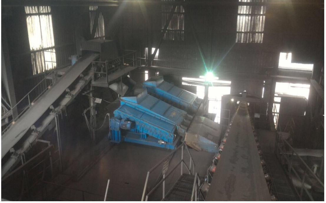
Şekil 2.9. Kok kırma eleme tesisi görünümü.
