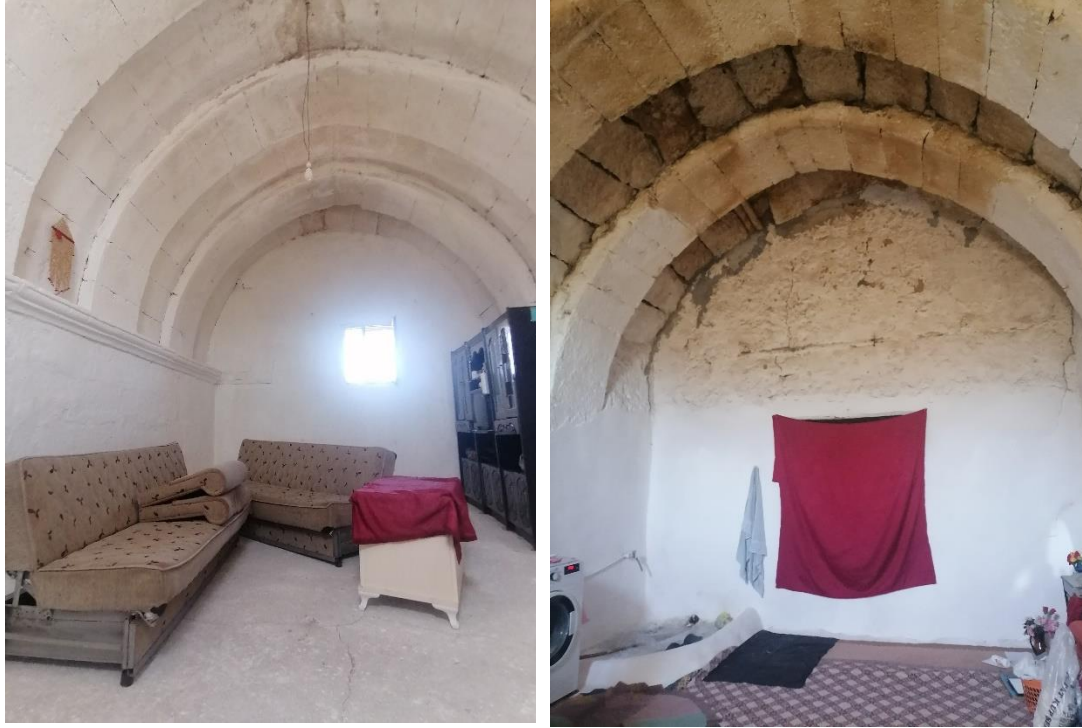
Şekil 5.4. Alayı Güner evinin duvarlarında oluşan çatlaklar
