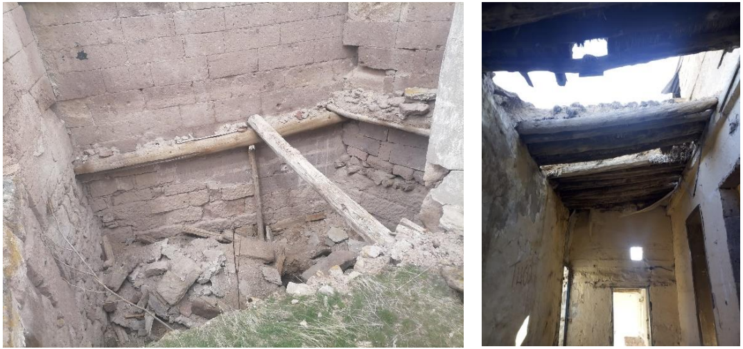
Şekil 5.3. İncesu evlerinde çatılardaki tahribat
