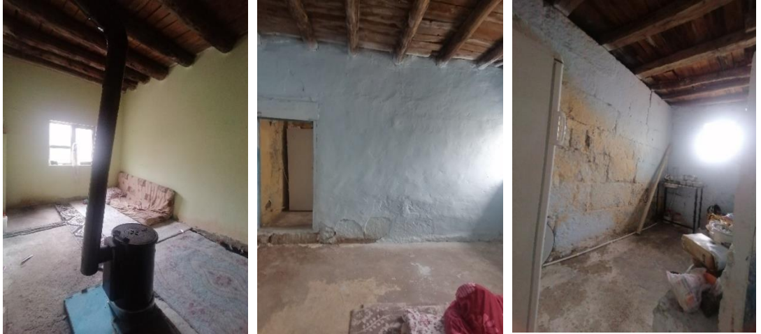
Şekil 5.1. İncesu evlerinin duvarlarındaki sorunlar
