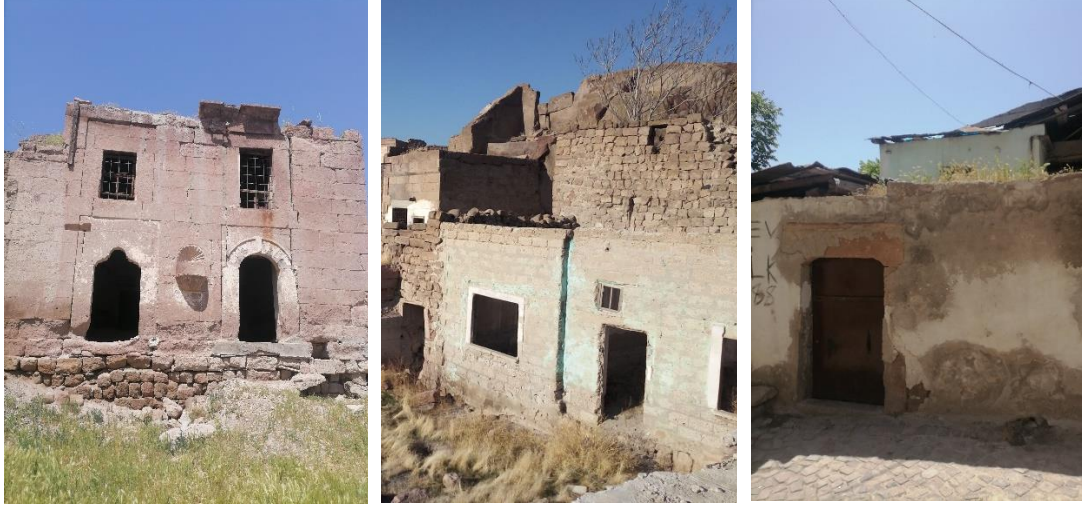
Şekil 5.6. İncesu evlerindeki kapı problemleri
