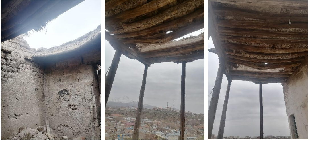
Şekil 4.179. Tahrip olmuş düz toprak damlı çatılar
