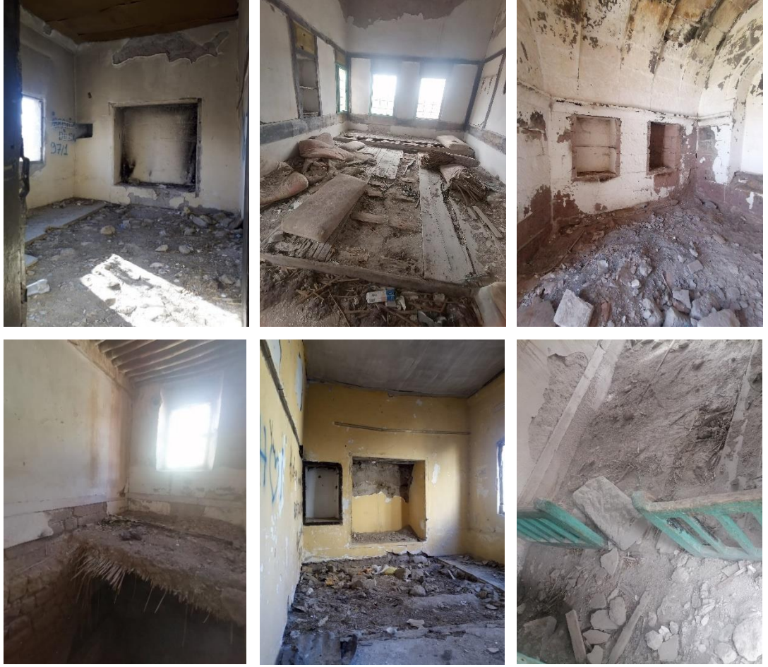
Şekil 5.5. İncesu evlerinde atıl durumdaki döşemeler
