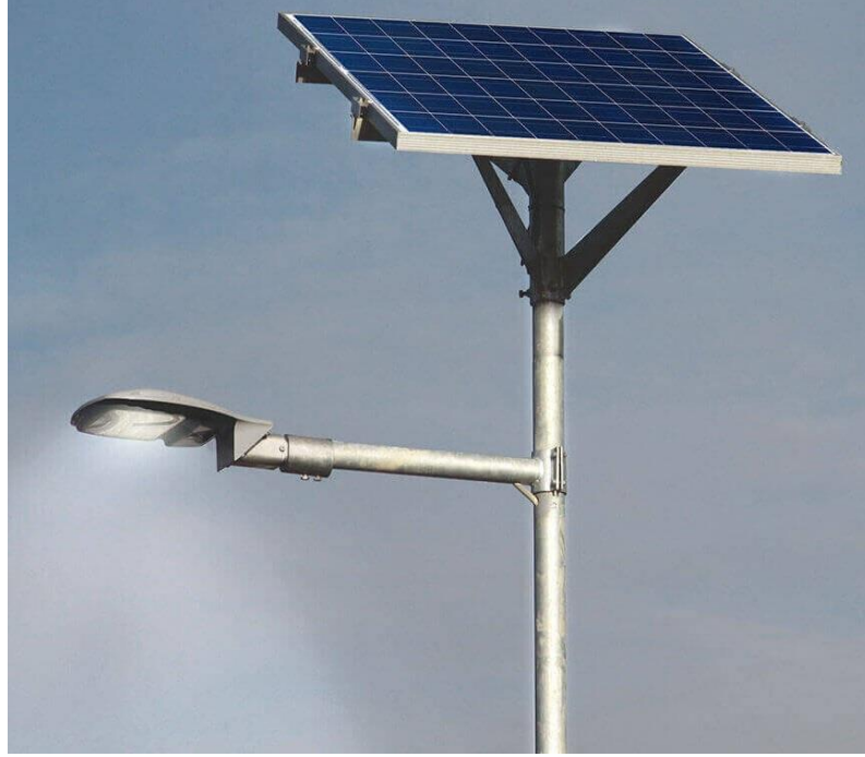
Şekil 3.14. Fotovoltaik sistem sokak lambası ( http://powersolar.com.tr , 2022).
