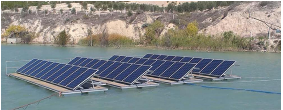
Şekil 2.8. Yüzer güneş santrali Azmak 2 Hidroelektrik Santrali ( tr.tyt.com.tr ).
