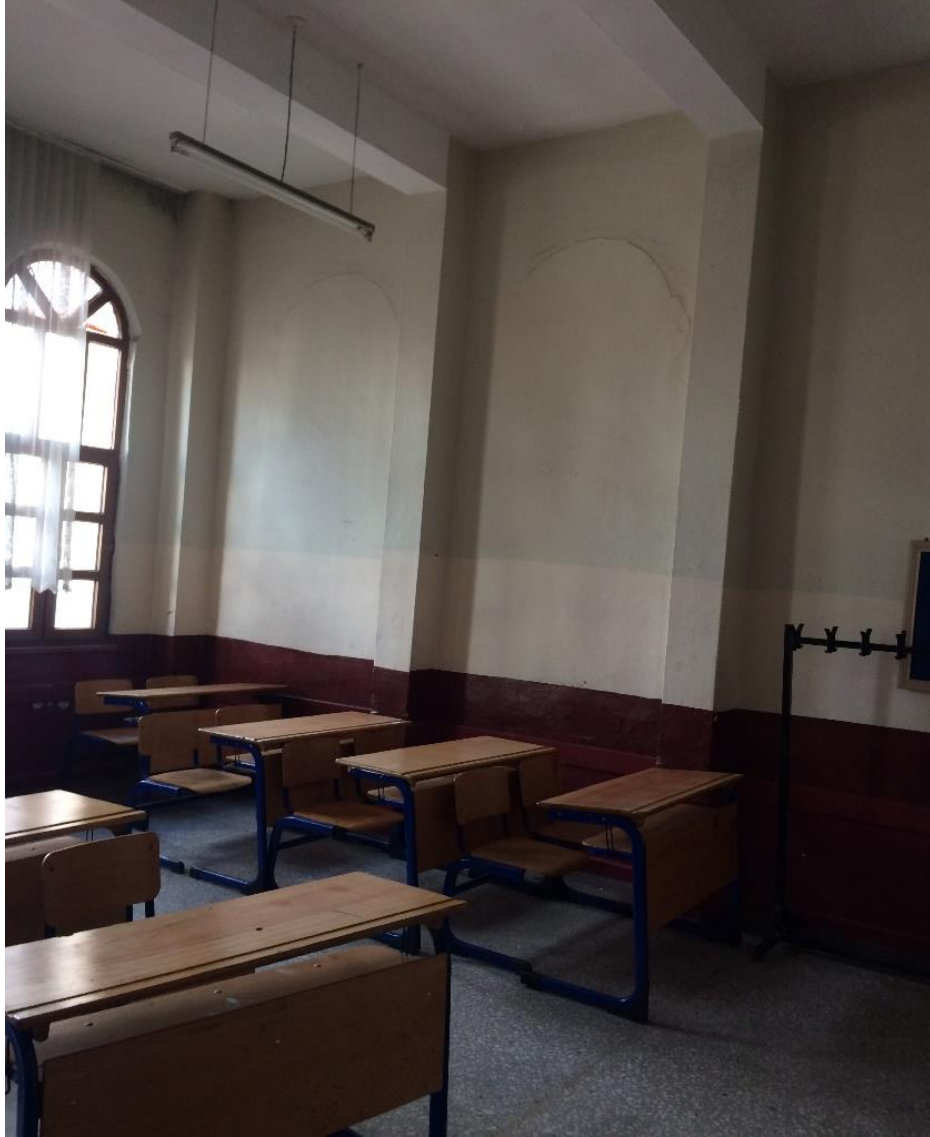
Şekil 3.126. Kuzey cephede kapatılan pencereler (Şar, 2020).
