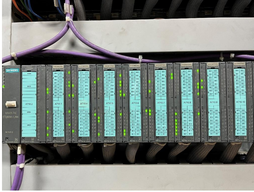
Şekil 4.13. Uzak I/O istasyonu görünümü.
