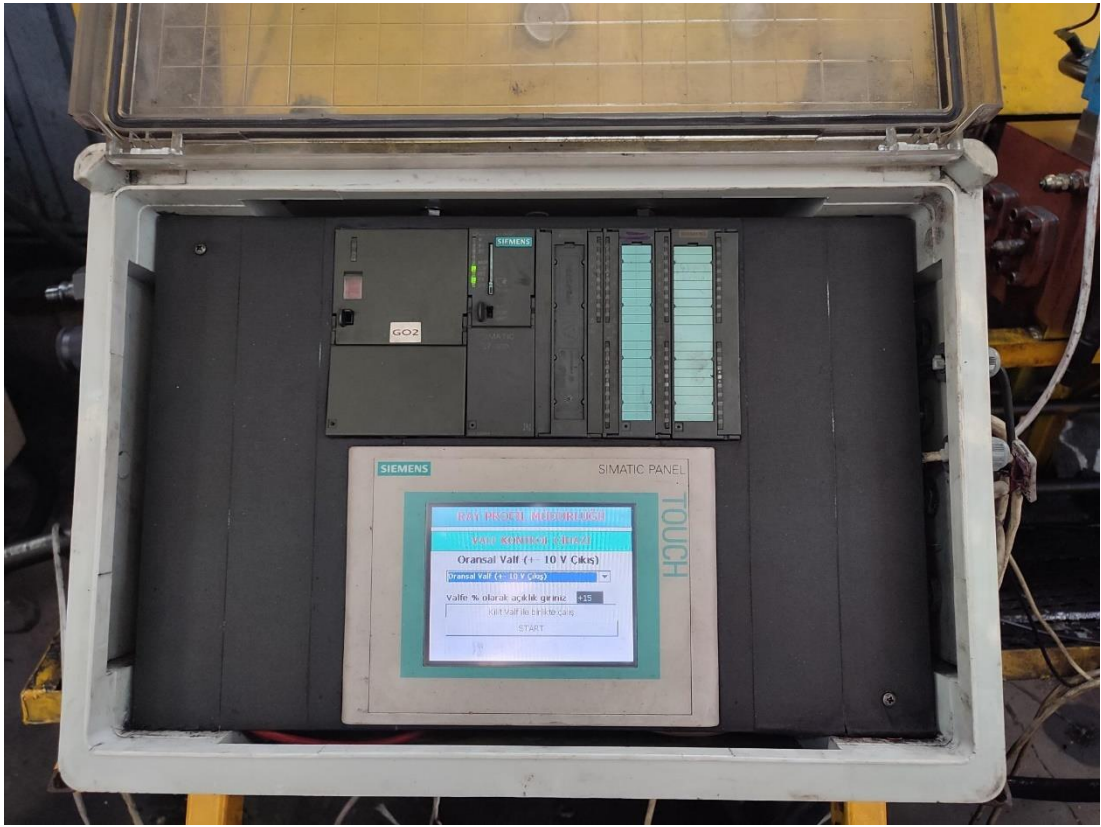
Şekil 5.1. S7-300 serisi PLC ile kurulan test ünitesi.
