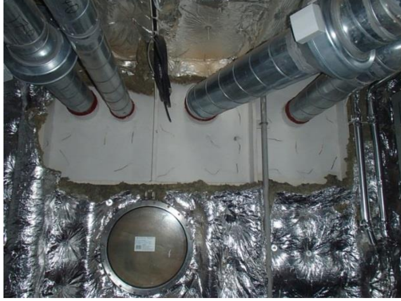
Şekil 3.18. Örnek havalandırma işi [17].
