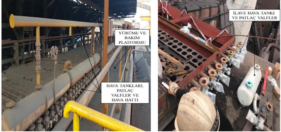
Şekil 30 İlave hava tankları, mevcut hava tankları ve üfleme borularının montajlarının saha montaj görseli
