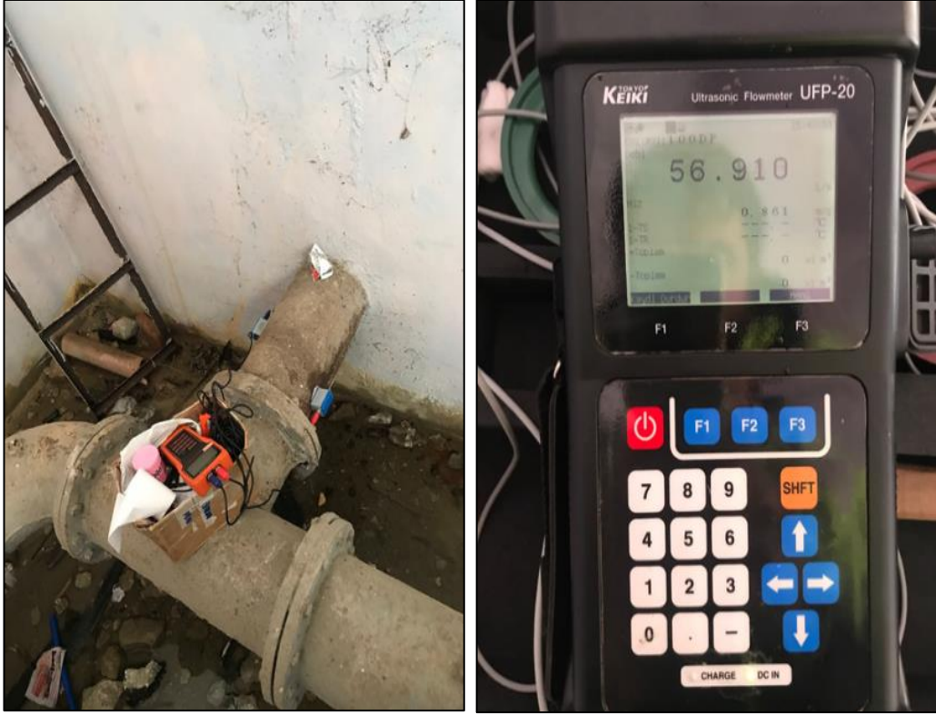
Şekil 2.29. İçmesuyu hattına bağlı debimetre Şekil 2.30. Ultrasonik Debimetre
