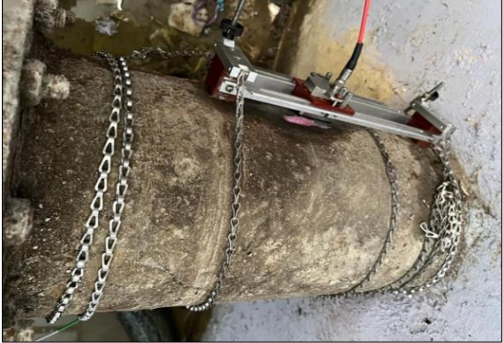
Şekil 2.28. İçmesuyu hattına bağlı debimetre
