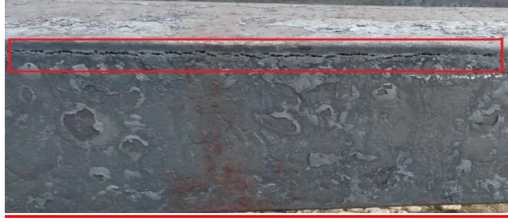
Şekil 4.5. Boyuna Köşe Çatlağı Örnek Görseli
