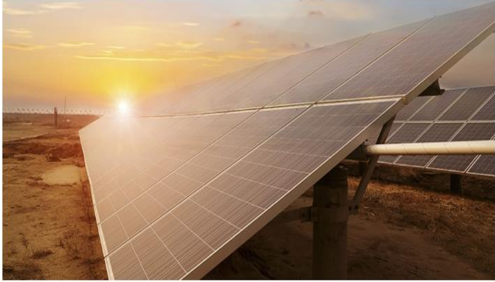
Şekil 1.5. Djermaya Solar tesisi [24].
