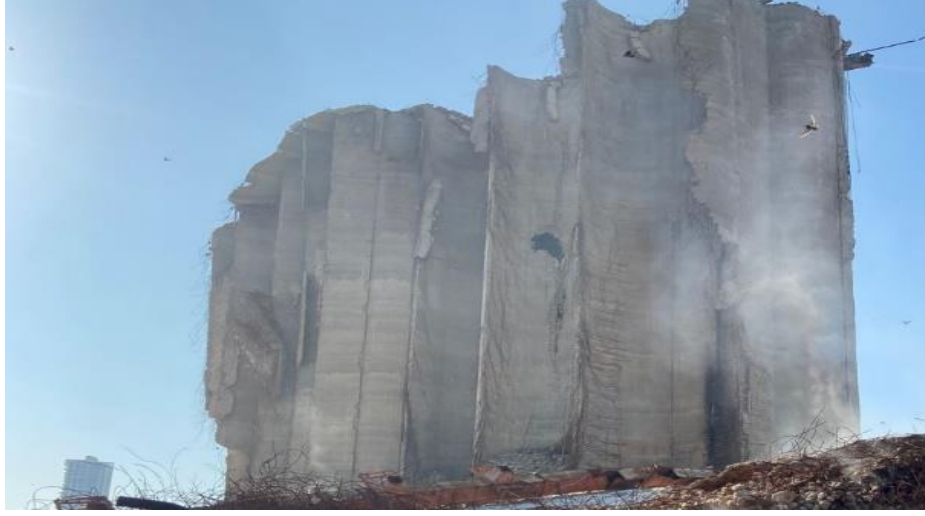
Şekil 3. 17. Hasarlı kısım. (Kaynak: yazar)
