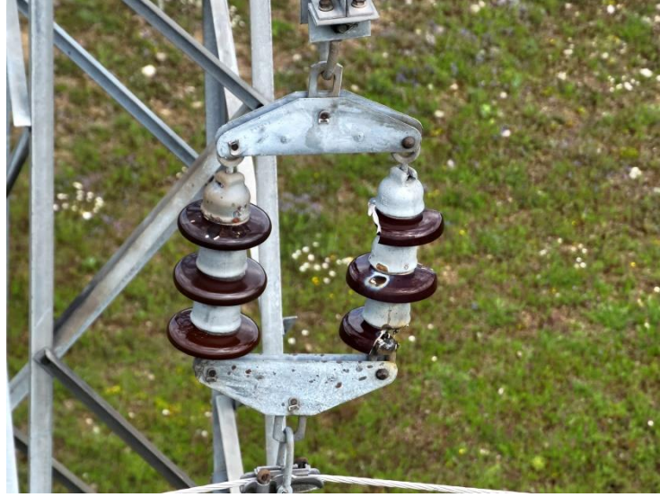
Şekil 3.4. Faz-toprak kısa devre arızası izolatör kırığı.
