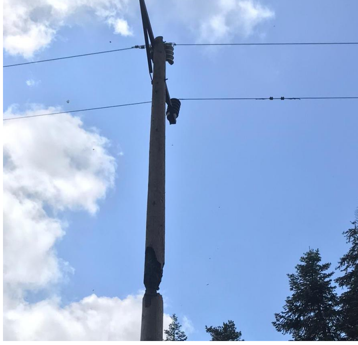
Şekil 3.5. Faz-toprak kısa devre arızası sıkı bağ kopması.
