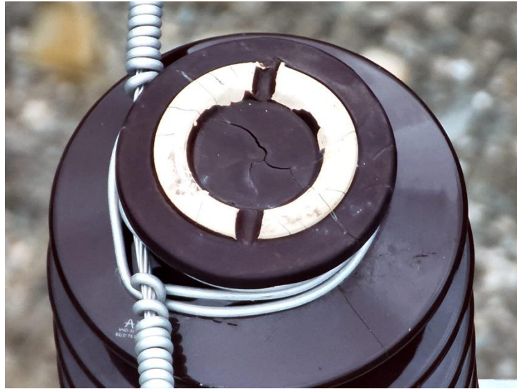
Şekil 3.6. Faz-toprak kısa devre arızası izolatör çatlağı.
