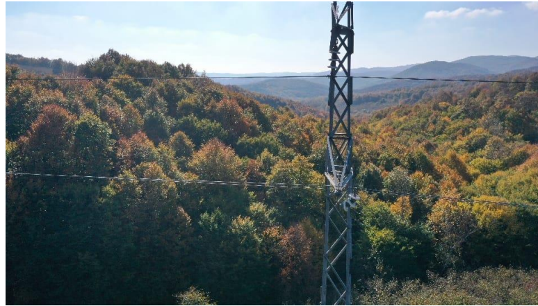
Şekil 4.27. Ağva fideri izolatör arızası.
