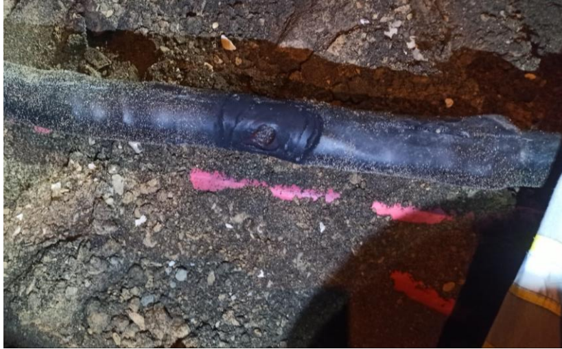
Şekil 3.2. XLPE Kablo Arızası.
