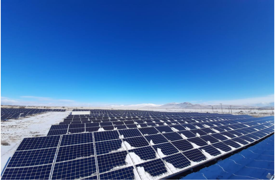
Şekil 3.8. Kurulumu tamamlanmış fotovoltaik sistemin kış mevsiminden görüntüsü
