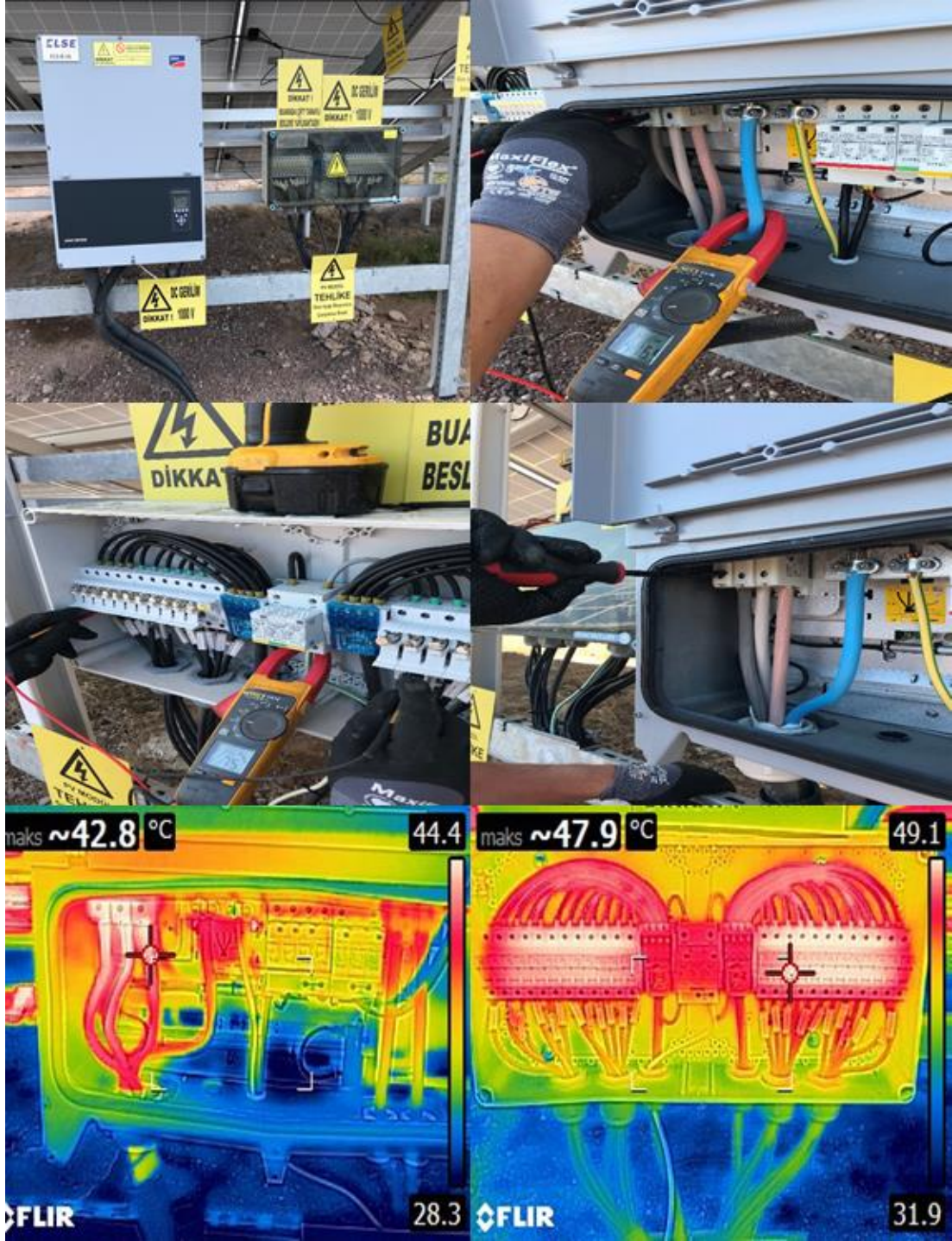
Şekil 4.9. İnverter ve DC toplama kutusu bakım kontrolleri
