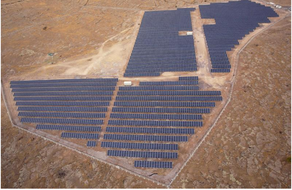
Şekil 3.7. Kurulumu tamamlanmış fotovoltaik sistemin yaz mevsiminden görüntüsü
