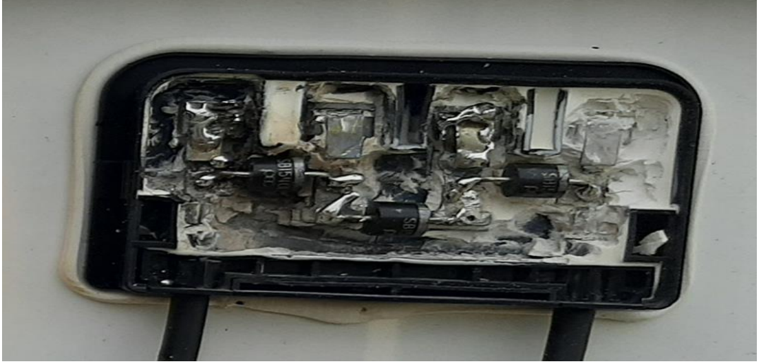
Şekil 4.11. Güneş paneli bağlantı kutusu iç görüntüsü
