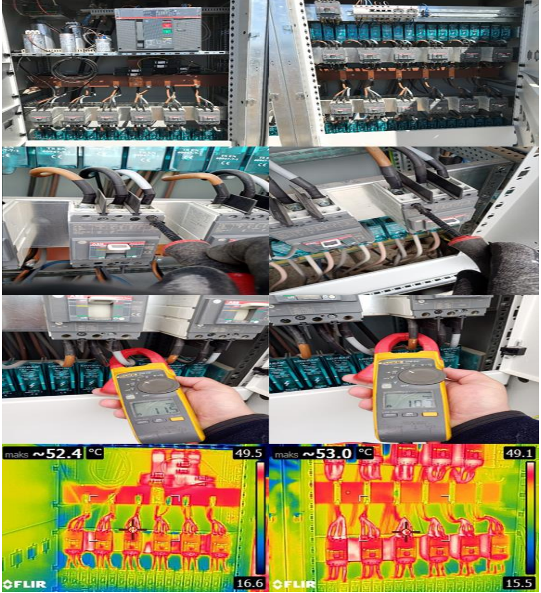
Şekil 4.16. AG pano bakım kontrolleri
