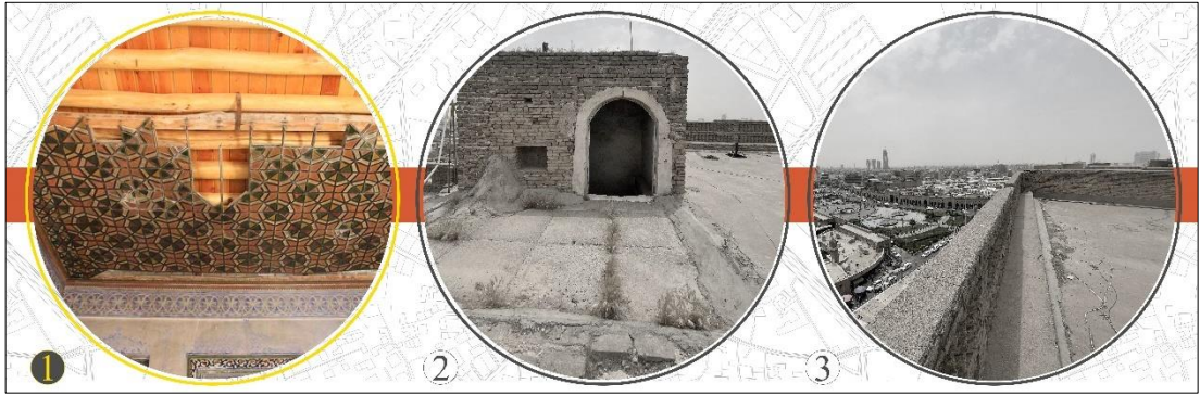
Şekil 4. 42. Çatı yapım tekniği 2; Su yalıtımı olarak beton tabaka 3; Binanın yetersiz drenaj eğimi
