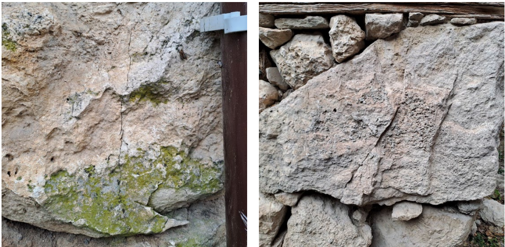
Şekil 5.1. Kagir duvarda kullanılan Yazıköy taşlarında görülen yüzeysel çatlak ve kırılma.
