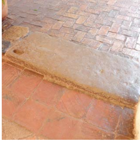
Şekil 5.10. Kolombiya, Villa de Leyva’da alışveriş merkezine çevrilen bir anıt eserde görülen bozulma (Ali & Murat, 2012)
