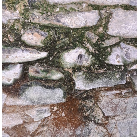
Şekil 5.22. Yazıköy çamaşırhanesinin toprakla temas halindeki duvarında görülen yosun ve liken oluşumu.
