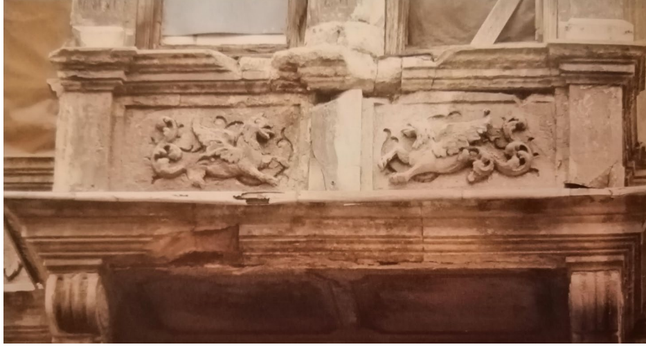
Şekil 2.30. Beyoğlunda taş cephede don etkisiyle oluşmuş parça kayıpları (Zakar & Eyüpgiller, 2015).
