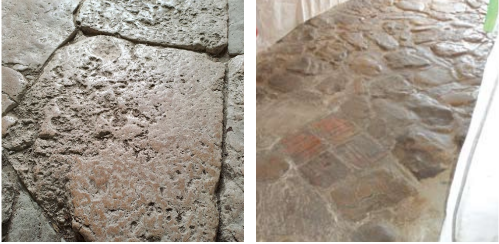
Şekil 5.18. Solda döşeme kaplaması olarak kullanılmış Yazıköy taşında görülen parlak görüntü, Sağda Kolombiya Villa de Leyva da eski bir han girişindeki taş döşemede oluşan parlak görüntü (Ali & Murat, 2012).
