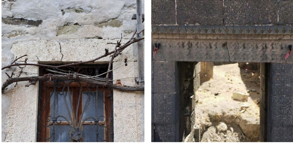
Şekil 5.2. Solda lento olarak kullanılan kırılmış Yazıköy taşı, sağda Diyarbakır Surp Sargis Kilisesi'nin lentosunda görülen çatlak (Işık & Halifeoğlu, 2017).
