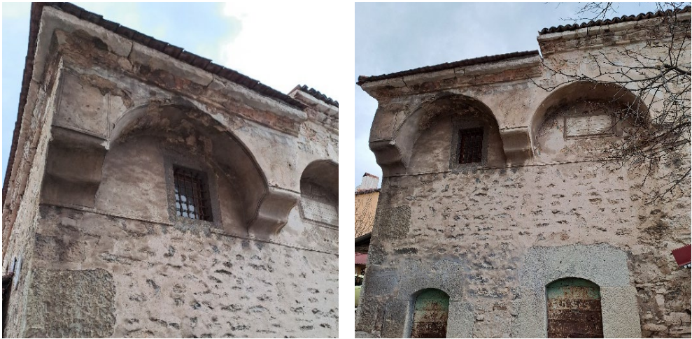
Şekil 5.21. Yazıköy Kilisesi üzerinde yangın izleri.
