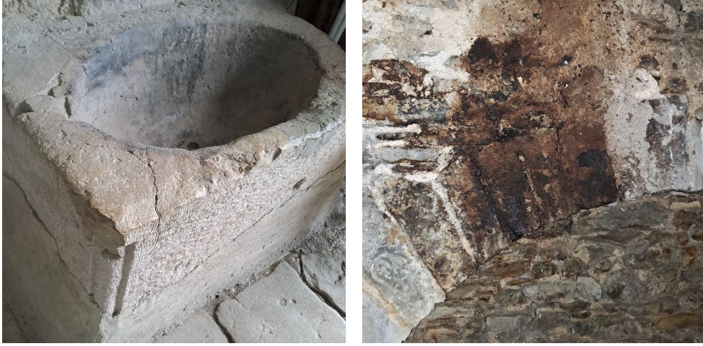
Şekil 5.16. İç mekânda kullanılan Yazıköy taşlarında neme bağlı renk değişimleri.
