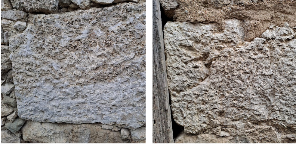
Şekil 5.7. Kagir duvarda erozyona uğramış Yazıköy taşı yüzeyi.
