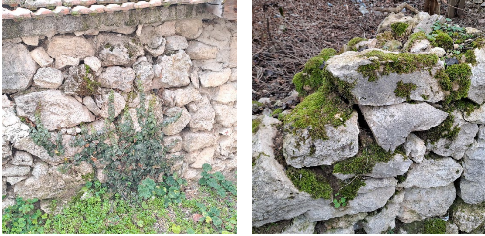
Şekil 5.24. Yazıköy taşıyla yapılmış duvarlarda görülen bitki gelişimi kaynaklı biyolojik yerleşim bozulması
