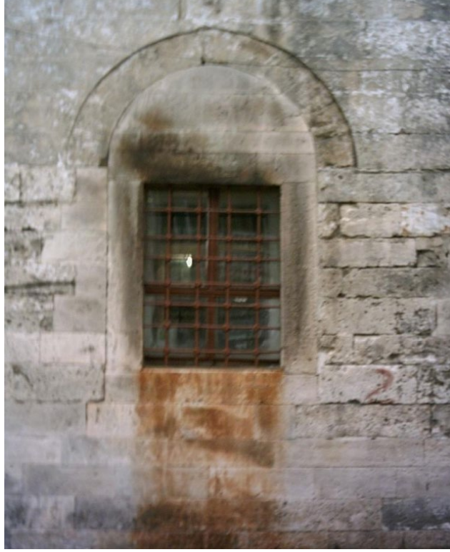
Şekil 2.31. Kırklareli Hızır Bey Hamamı'nda lekelenme ile bozulma örneği (Ali & Murat, 2012; Zakar & Eyüpgiller, 2015).
