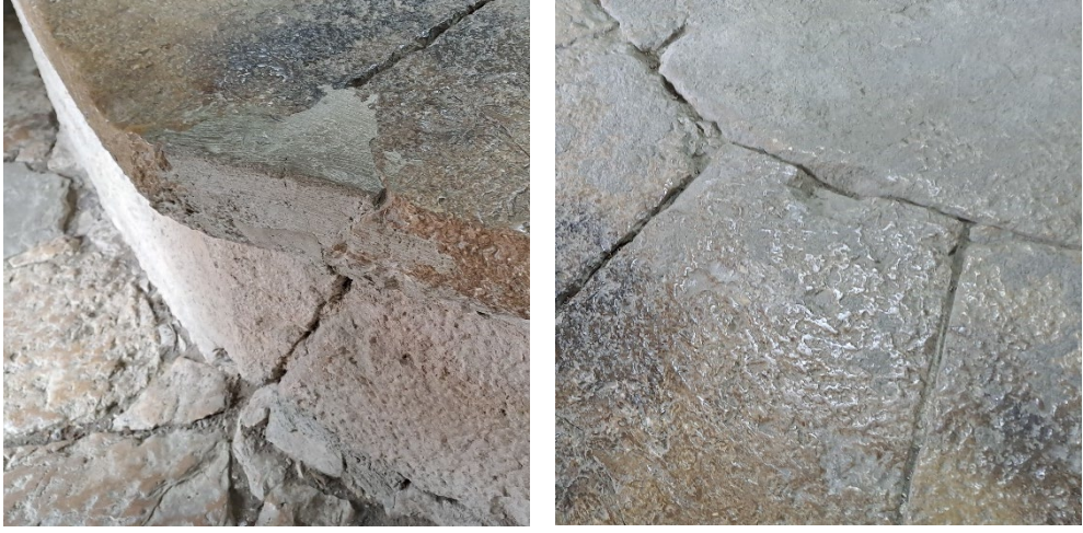
Şekil 5.9. Yörük köyü çamaşırhanesinde görülen kırılma ve parça kaybı.
