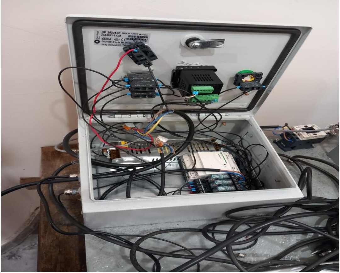
Şekil 4.11. Mekanik Boşaltım Sistemi Kontrol Paneli
